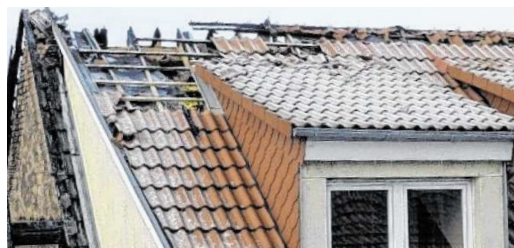
Die Flammen griffen über und zerstörten größtenteils den Dachstuhl.
